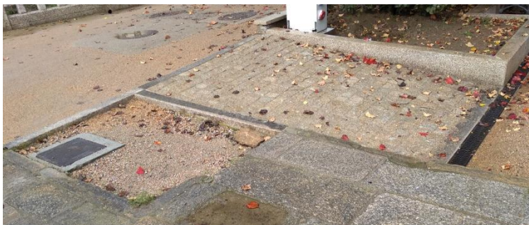
Imaxe 2: Espazo diante do edificio do Concello que non se adecuou na última reforma da Alameda
